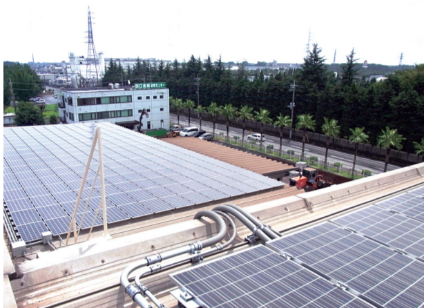
【丘里工場の太陽光発電パネル】奥は本社研修センター
