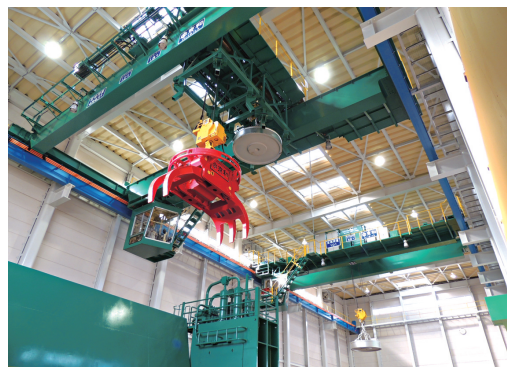
京和工業製天井クレーン
